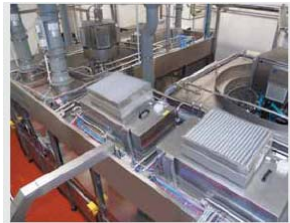
Приточно-вытяжная система на асептической фасовочной машине
