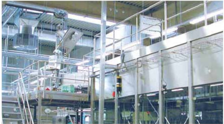
УЛЬТРАКЛИН® - защитная чистая зона для фасовочных машин в производственном цехе
